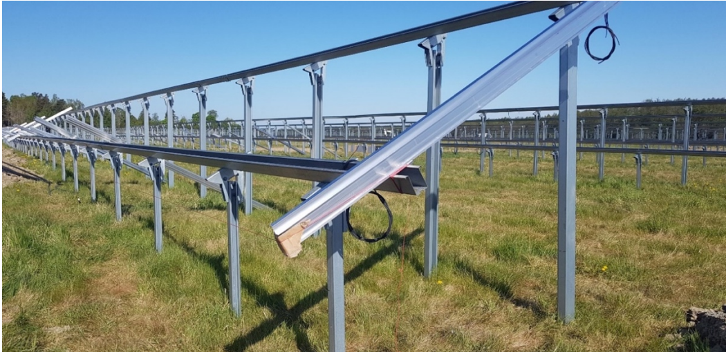
Figur 4. Bild på montagesystemet (EnergiEngagemang 2024).
