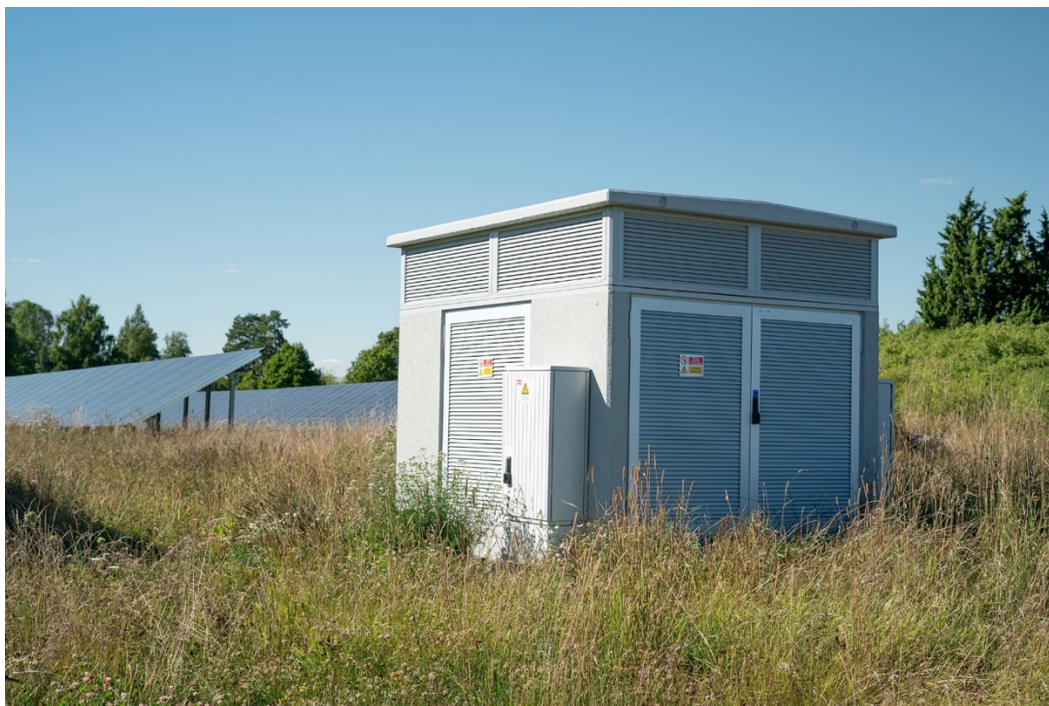
Figur 7. Exempelbild på en transformatorstation (EnergiEngagemang 2024).
